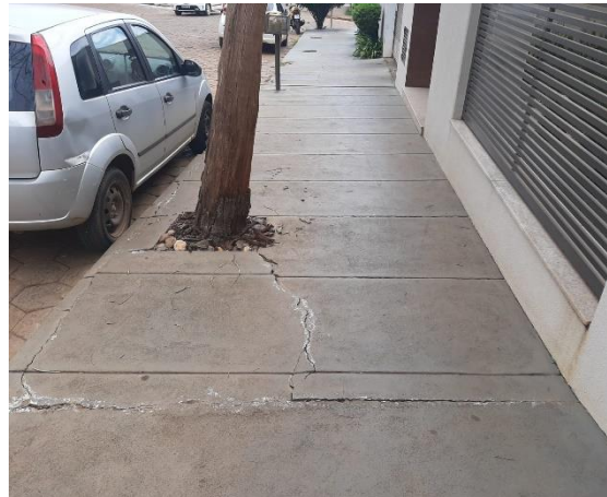
Figura 02: Rachadura causada pelas raízes da planta.
